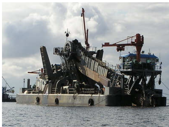
Прокарване на подводна траншеи по дъно с много роторен багер - з/с "Samatlor". Производител: Германия. Производителност 400 м3/час.
